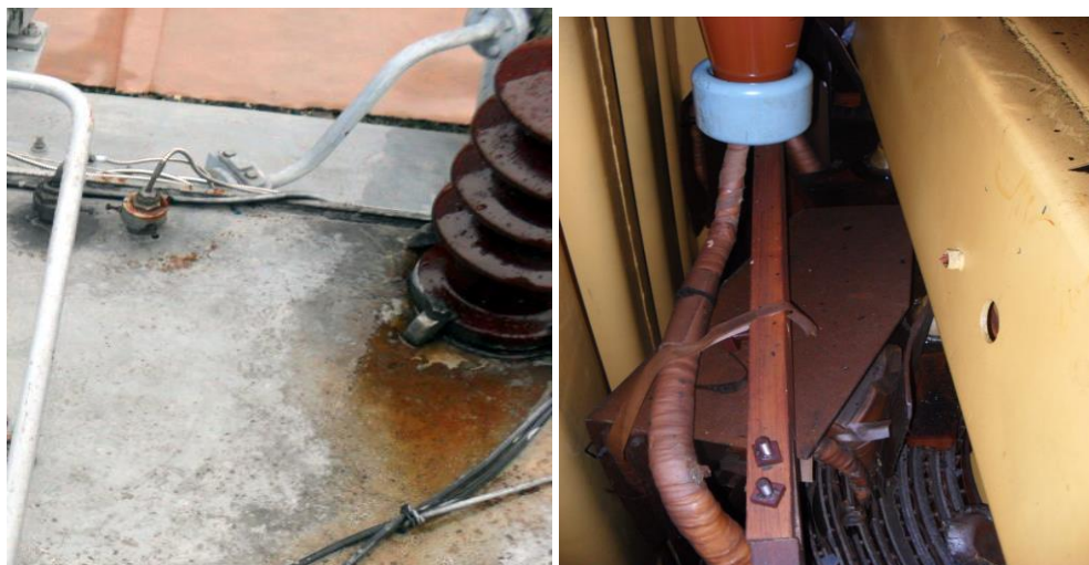
Gambar 3.7. Bushing sekunder yang mengalami rembesan, Gambar 13 Kerusakan pada belitan bagian head winding
